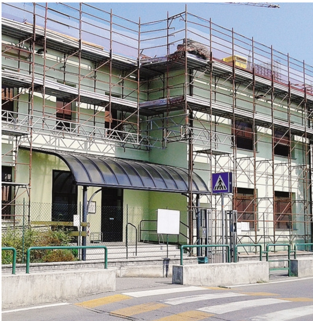
Il cantiere delle scuole elementari alla Basella di Urganano per la sostituzione del tetto
